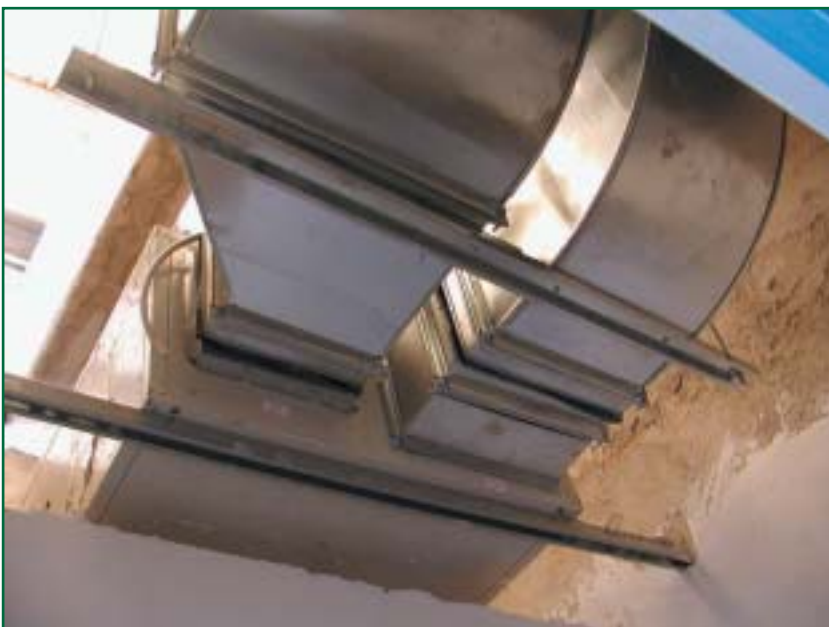
Vista della ripresa e della mandata del recuperatore.
