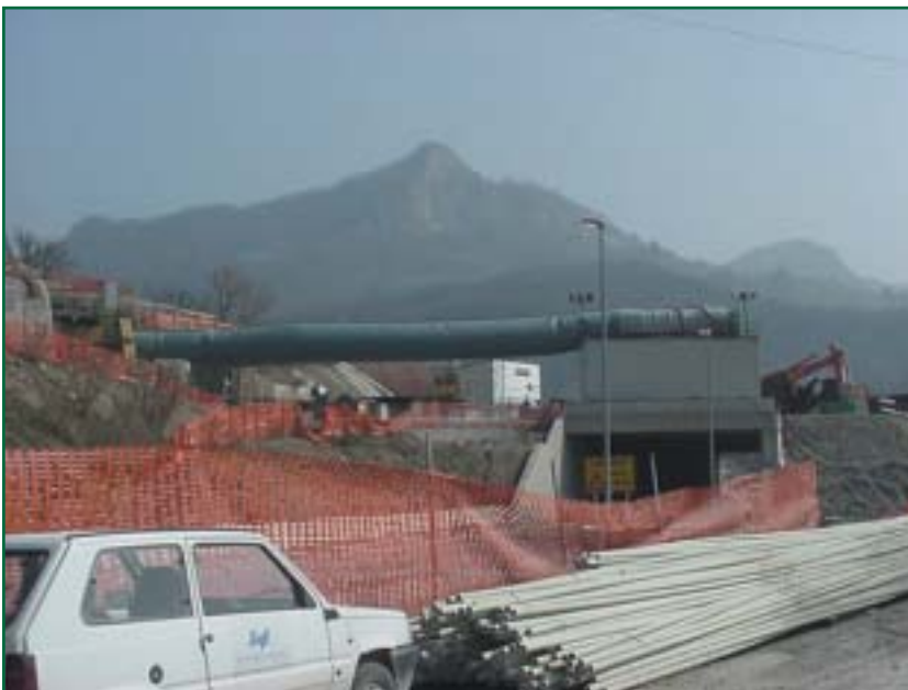
La quantità d'aria necessaria per la ventilazione viene in genere calcolata in base ai mezzi Diesel presenti in galleria nella fase più critica dello smarino.
