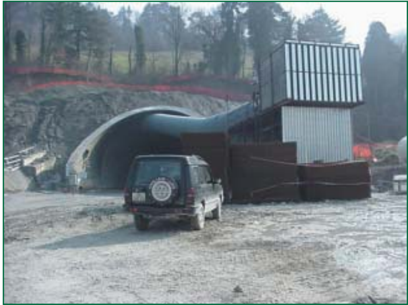
Sistema di insonorizzazione a setti fonoassorbenti previsto all'imbocco della galleria Monte Mario, cantiere variante di valico A1 Sasso Marconi (BO), per il contenimento delle emissioni sonore lato aspirazione della stazione di ventilazione costituita da 2 ventilatori assiali 160KG da 250 kW 4poli.
