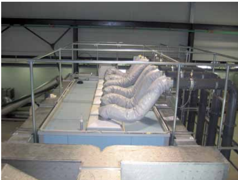
L'immissione dell'aria avviene attraverso un soffitto mobile e modulare, composto da sei cassonetti filtranti.
