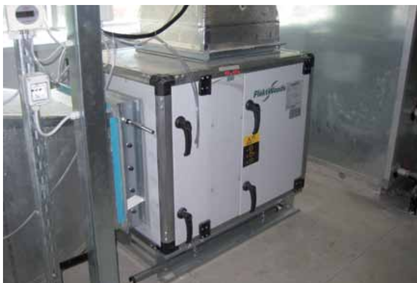
Il cassonetto per l'espulsione dell'aria posizionato sul soppalco.
