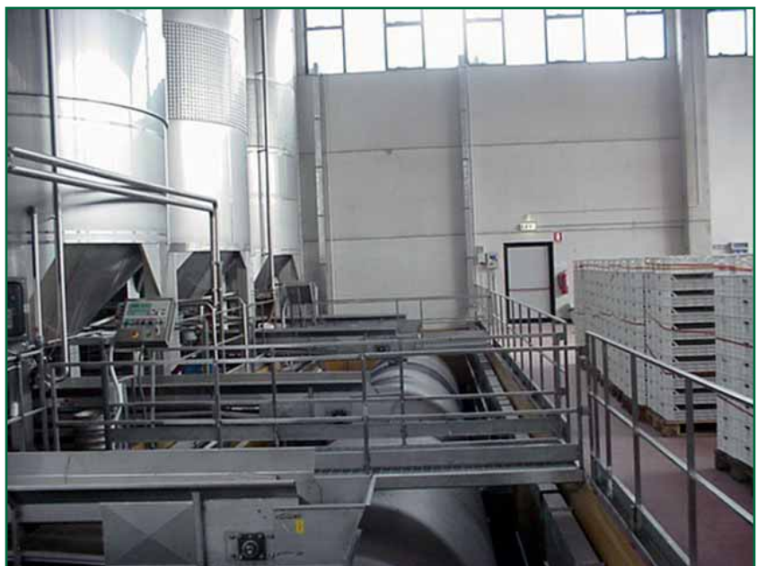
Fossa di pigiatura: la CO 2 in caduta dai serbatoi potrebbe essere altamente pericolosa per il personale addetto alla manutenzione se non preventivamente eliminata. Sullo sfondo, vista dei due condotti paralleli di estrazione in acciaio inox.
