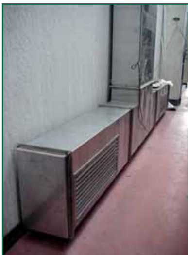
Vista del canale inox di estrazione della CO 2 della zona serbatoi.
