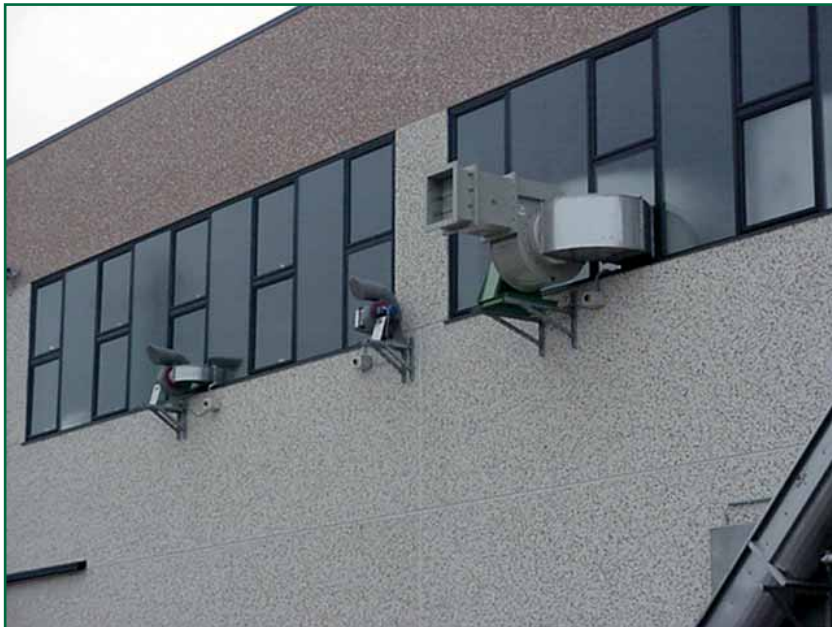
Ventilatori di estrazione in polipropilene posti all'esterno.
