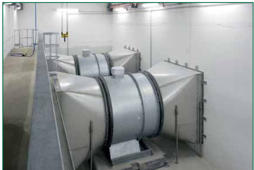
Due grandi ventilatori assiali installati in una delle camere di ventilazione.
