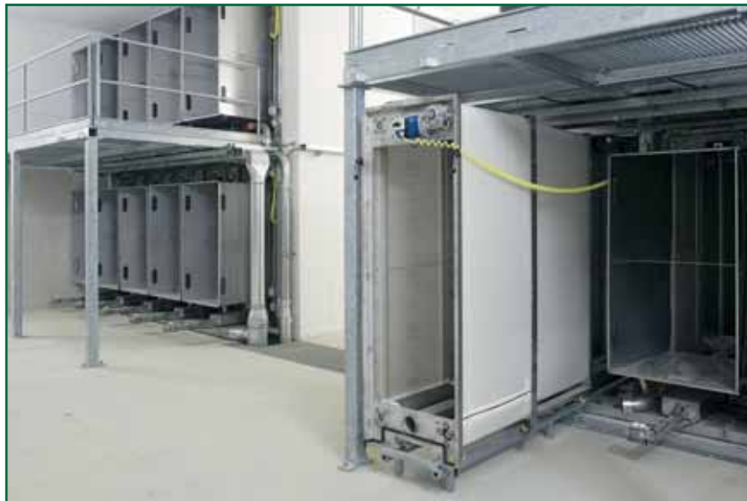
I collettori di raccolta del sistema di filtrazione ECCO.
