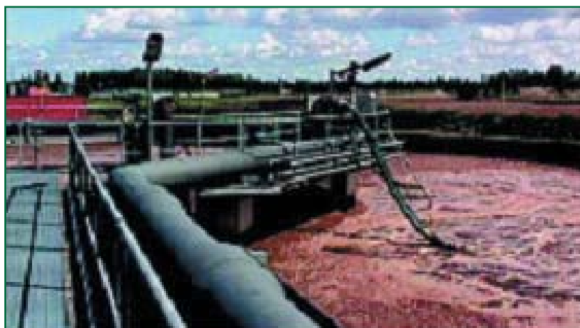
Figura 1 - Trattamento biologico acque reflue
