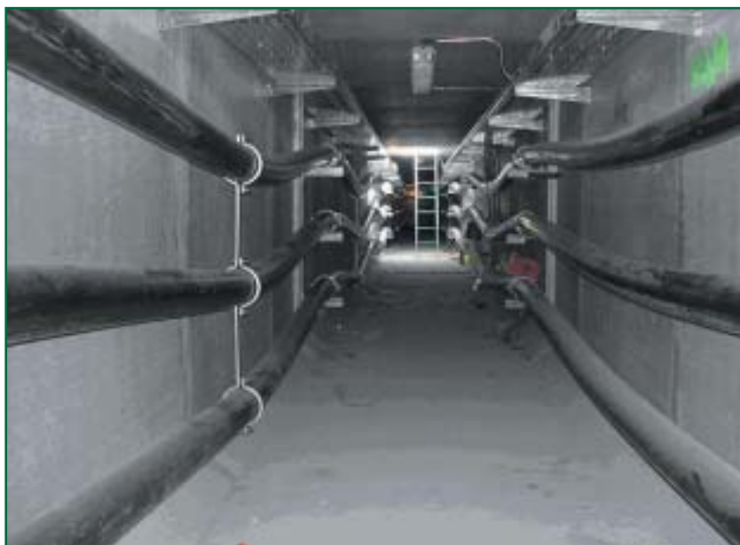
Figura 2 - Foto dei due circuiti di cavo in galleria sotterranea
