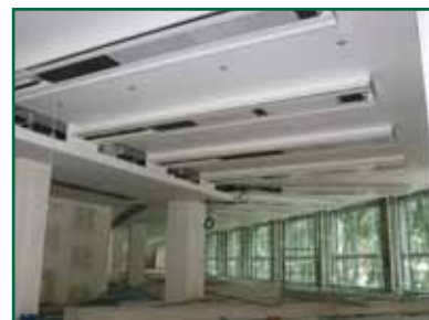
L'installazione delle travi fredde nel palazzo uffici di via Bergognone a Milano.
