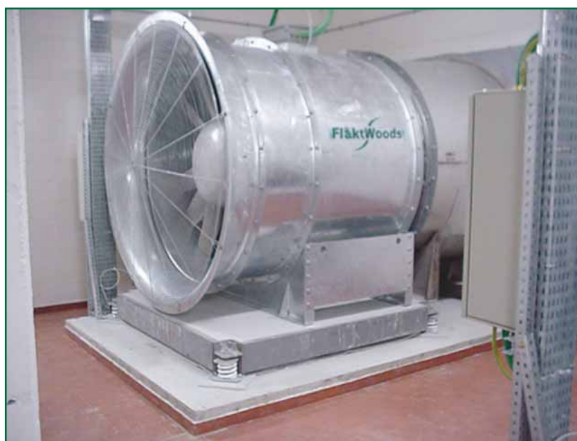
Uno degli elettroventilatori utilizzati nelle camere di ventilazione della nuova stazione Maciachini.
