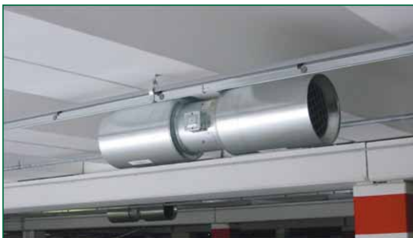
Fig. 2 - Uno dei ventilatori jefans installati.
